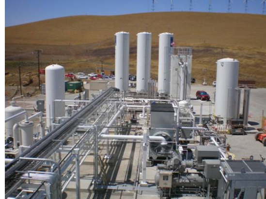
LNG Facility at WM's Altamont Landfill
